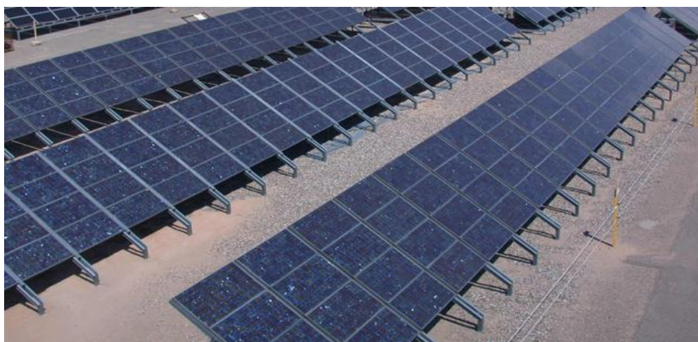
Slika 2. Fotonaponski solarni sustav (Izvor: http://www.zelenaenergija.org/clanak/solarne-fotonaponske-celije-fotocelije/429 , 2016.)
