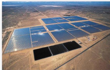
Slika 3: Parabolična protočna TE 30 MWe, Kramer Junction, California
