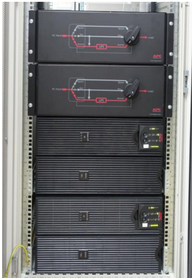
Slika 19. UPS-ovi u podatkovnom centru
