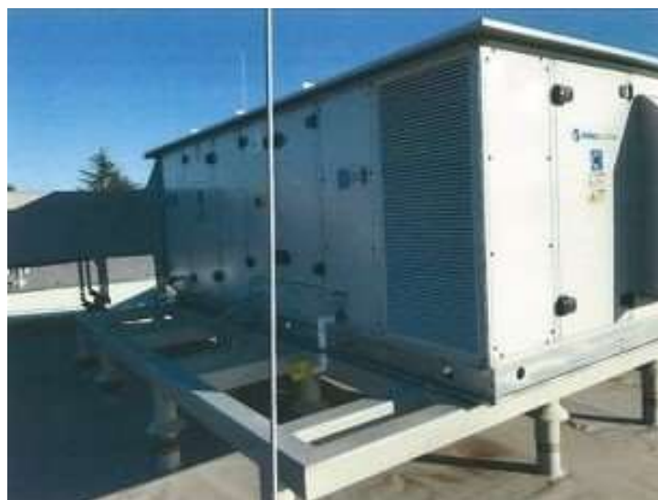
Slika 12 Klima komore dvorane
