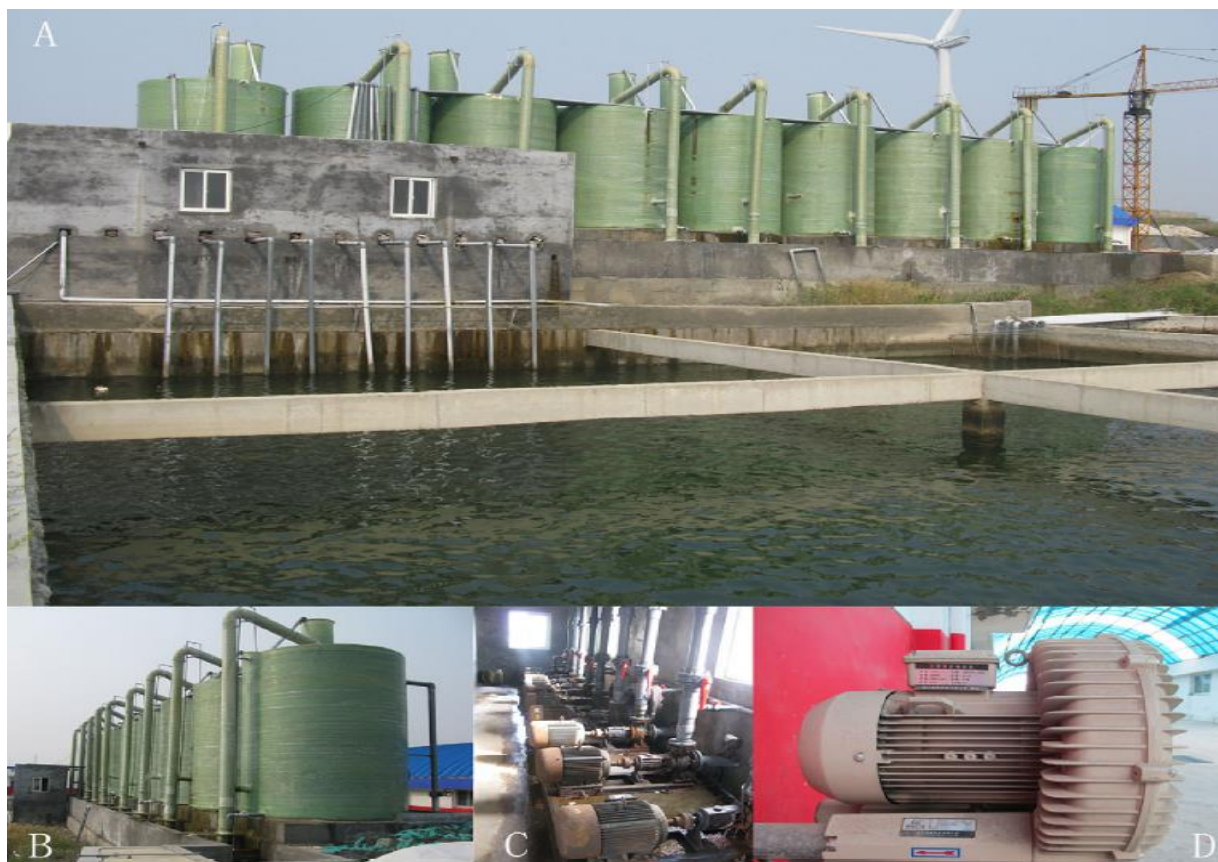
Slika 9. Tipični filtracijski sustavi i pumpe koji se koriste za uzgoj A. japonicus . (A) Taložnica (sprijeda) i pješčani filtri (straga) za izdvajanje suspendiranih čestica iz vode. Vjetrogeneratori se sve češće koriste za dobivanje električne energije u objektima za akvakulturu A. japonicus . (B) Pješčani filter za mehaničku filtraciju. (C) Unutarnja pumpa za recirkulaciju vode u sustavu (D) Zračne pumpa (Izvor: A,B,C - Shilin Liu, 2015; slika D: Yucen Bai, 2015).
