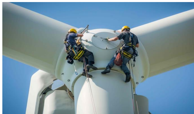
Slika 6. Prikaz održavanja vjetroelektrane
