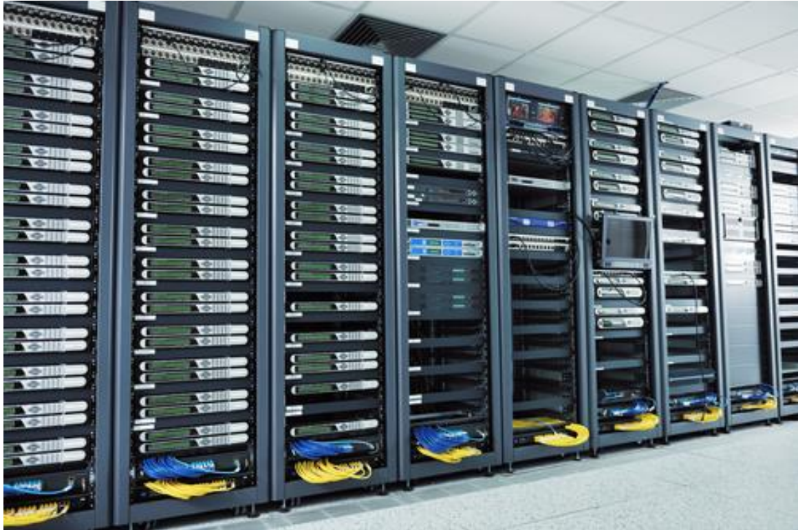
Slika 1. Primjer poslužiteljske sobe ( Server room example, 2017 )
