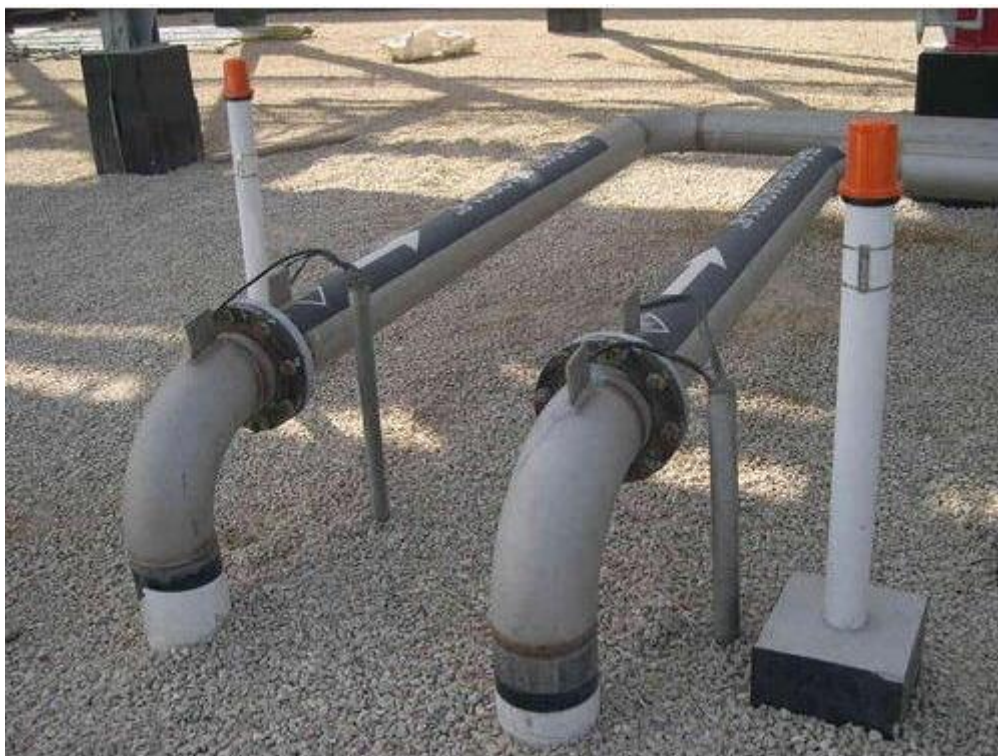
Slika 21 Vidljivi cjevovodi sa sustavom katodne zaštite. Izvor: https://5.imimg.com/data5/ST/JO/ID/SELLER-7533635/cathodic-protection-system-for-pipelines-500x500.jp
