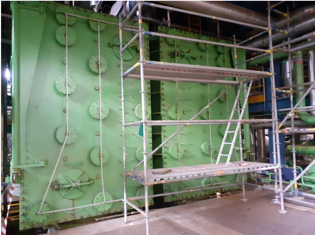
Slika 29 Prikaz prednje strane kondenzatora, tj. prednje strane dviju ulaznih vodenih komora. Vidljivo je kako svaka posjeduje 15 anoda. Izvor: Autorska slika
