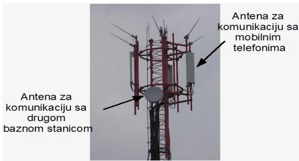
Slika 2.4. Fizički izgled bazne stanice
