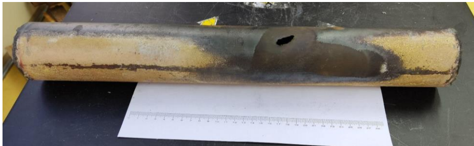
Slika 14: Cijev s pukotinom iz TE Plomin
