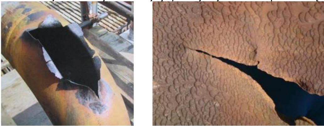
Slika 11: Posljedica erozijske korozije je pucanje cijevi za transport nafte [33]
