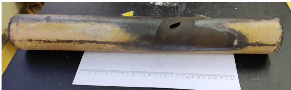
Slika 14: Cijev s pukotinom iz TE Plomin
