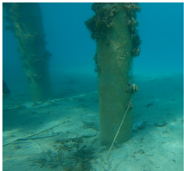
Slika 17. Metalni stupovi unutar vode s obraštajem (izvor: osobna arhiva).
