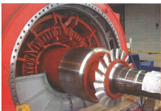
Slika 48. Generator TE Plomin 2 [9]
