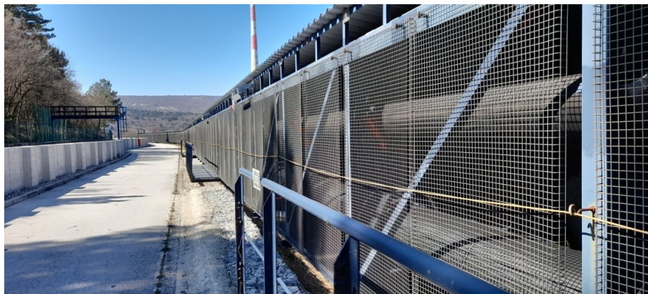
Slika 30. Transportni sustav ugljena prema elektrani [autor]
