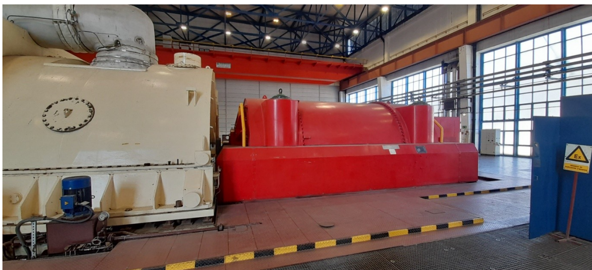
Slika 23. Spoj turbine i elektro-generatora (crveno kućište) [autor]
