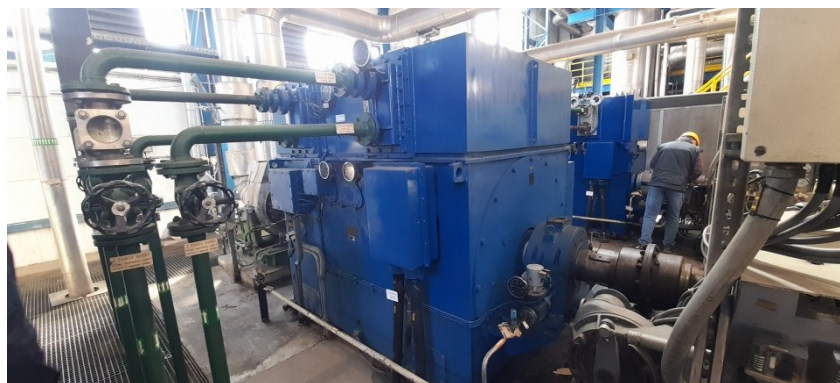
Slika 47. Pumpa napojne vode TE Plomin 2 [autor]
