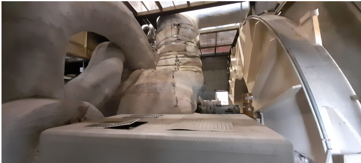
Slika 39. Srednjetlačni dio turbine [autor]
