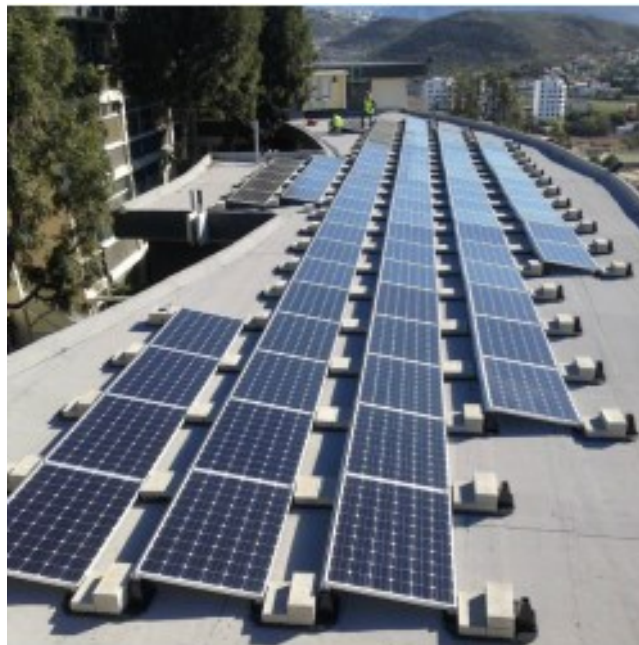
Slika 20. Fotonaponski sustav za ravni krov
