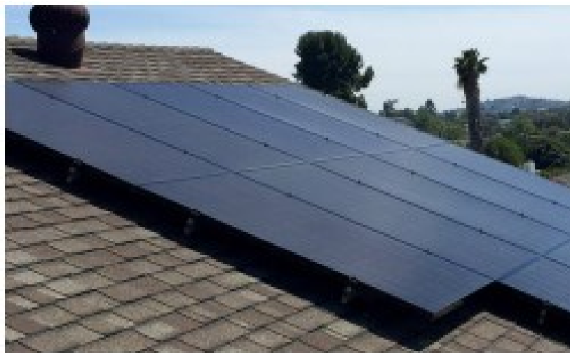
Slika 19. Fotonaponski sustav na tračnicama za kosi krov
