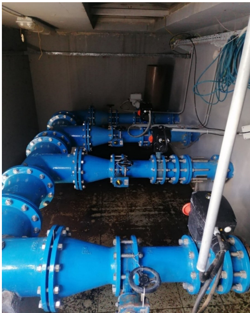
Slika 26. Zasunska komora u crpnoj stanici [19]
