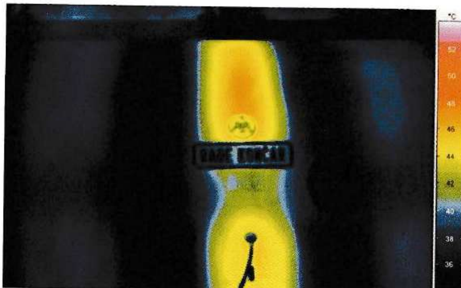
Slika 4.18 Izlazni rezultat periodičkog nadzora turbogeneratorskog motora termografijom
