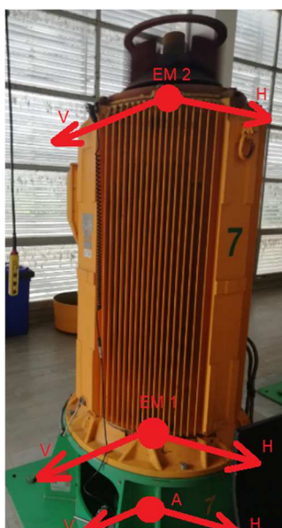
Slika 5.10 Karakteristični položaji i smjerovi mjerenja vibracija CA crpne stanice Gradole
