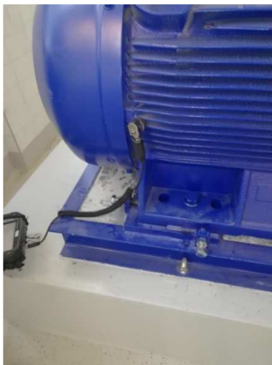
Slika 5.7 Mjerenje vibracija u smjeru H na položaju EM2 CA 1 crpne stanice Sv. Stjepan
