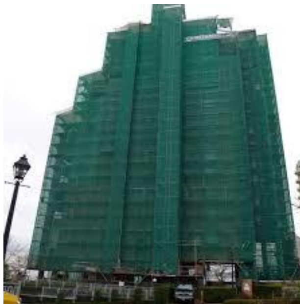
Slika 20. Zaštitna mreža na zgradi
