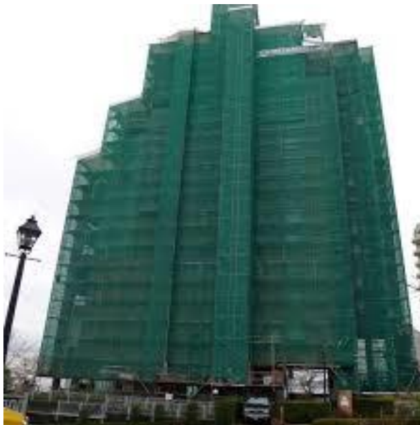
Slika 20. Zaštitna mreža na zgradi
