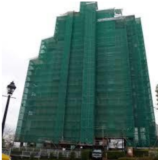
Slika 20. Zaštitna mreža na zgradi
