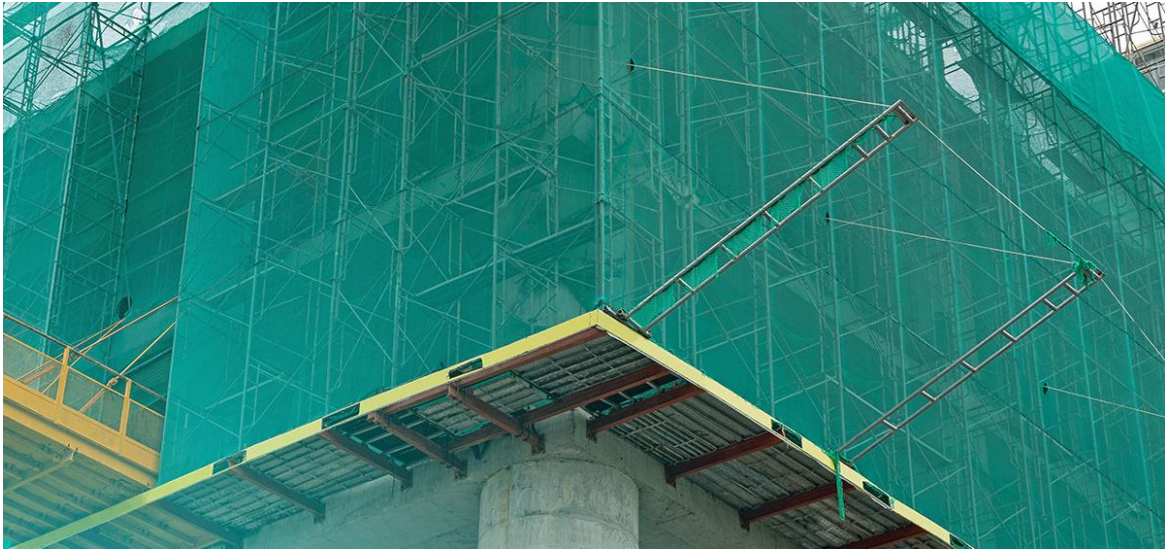
Slika 5. Zaštitna mreža na zgradi
