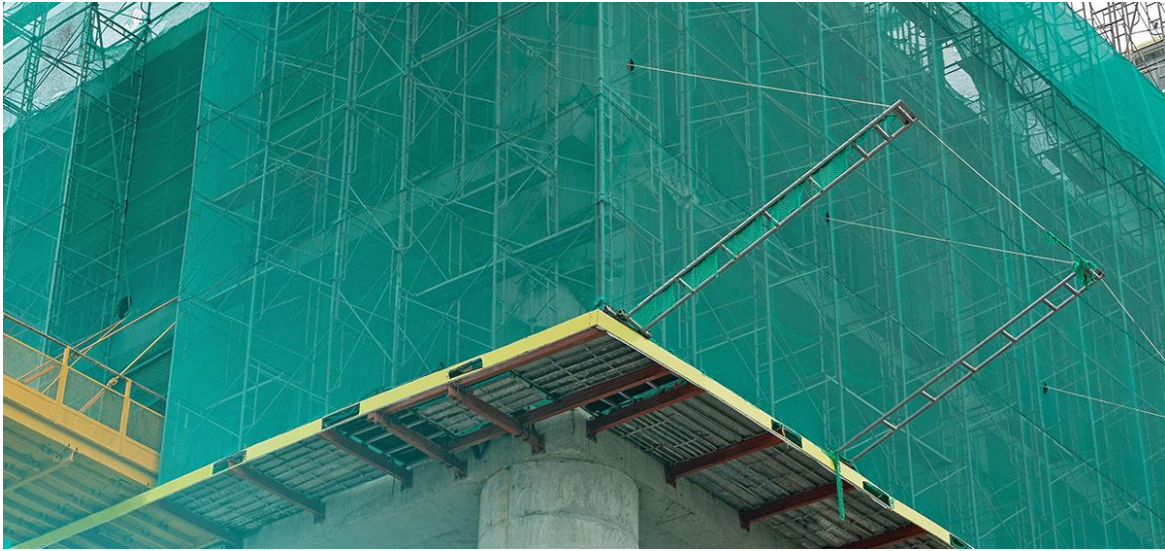
Slika 5. Zaštitna mreža na zgradi
