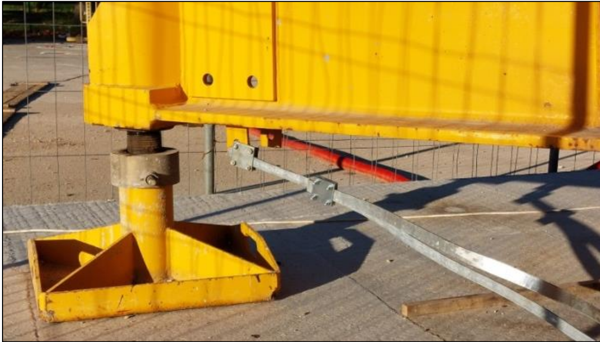
Slika 7: Spoj uzemljivača na metalnu konstrukciju dizalice
