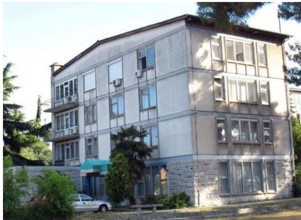
Slika 2. Ruševna zgrada u Labinu
