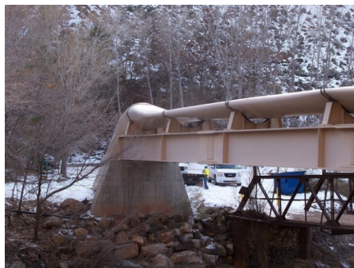
Slika 2.10. Kolaps cijevi u SAD, 1820 mm čelična cijev
