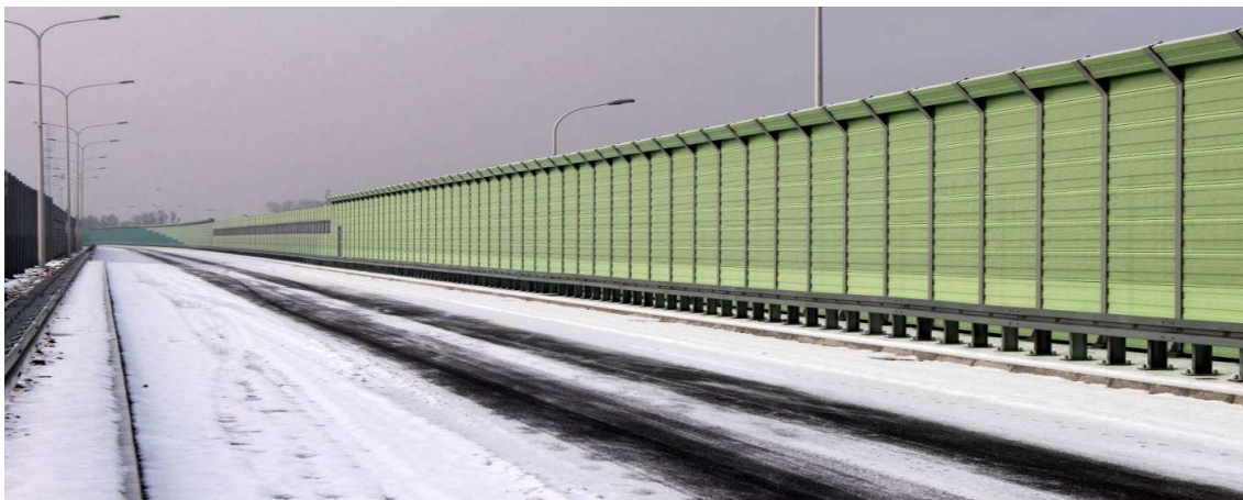
Slika 7 Aluminijski paneli za zaštitu od buke
