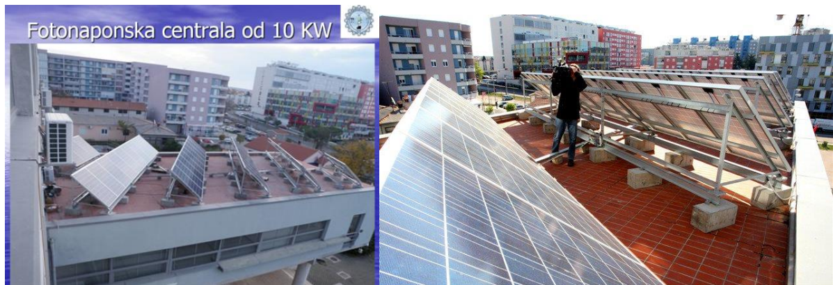
Slika 16 Pozicija fotonaponskih panela smještenih na strukovnoj školi Vice Vlatkovića u Zadru
