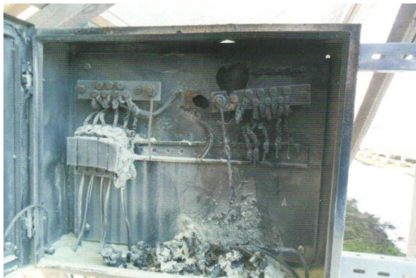
Slika 6 Uništeni DC spojni ormar
