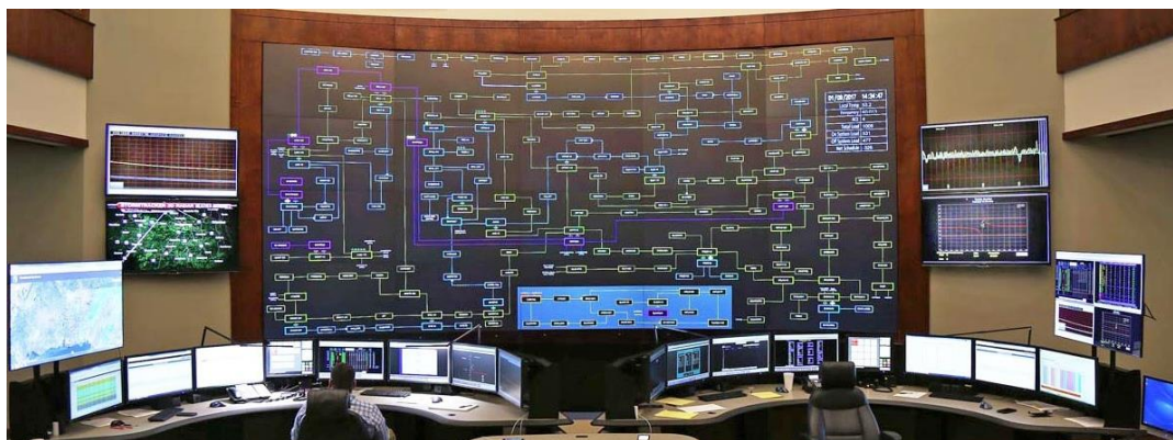
Slika 3: Kontrolna soba za nadzor elektro-energetskog sustava (LAMB, 2021)
