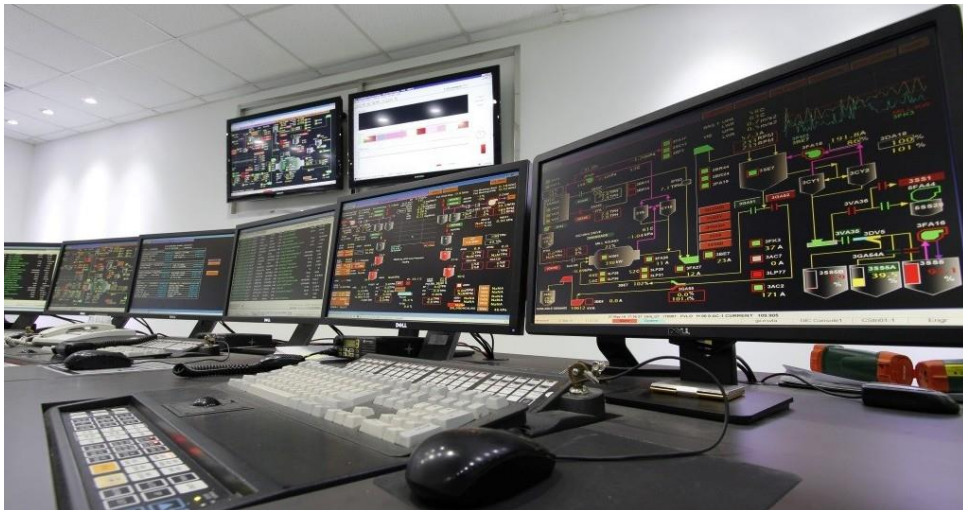
Slika 2: Kontrolna soba za nadzor proizvodnog procesa – HMI (GIC, 2017)
