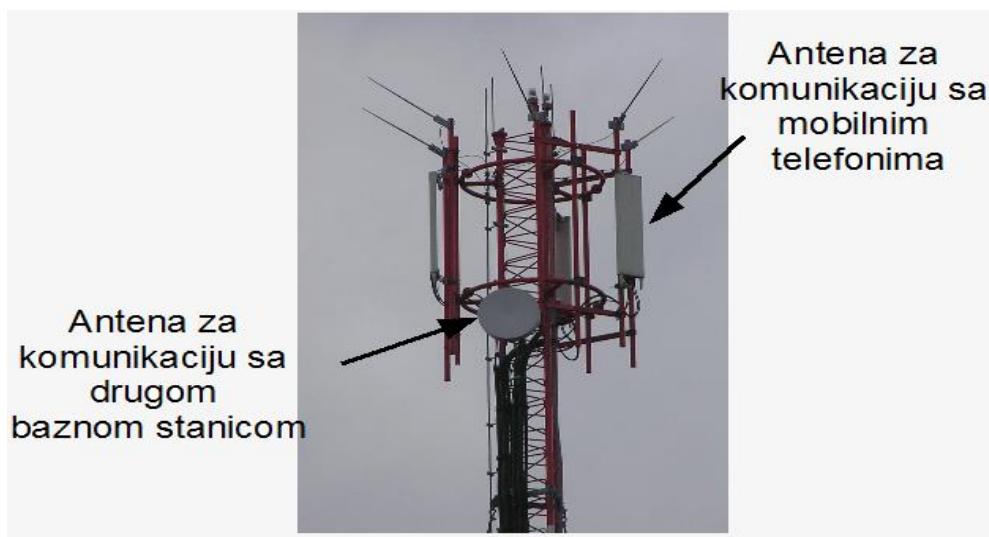
Slika 2.4. Fizički izgled bazne stanice
