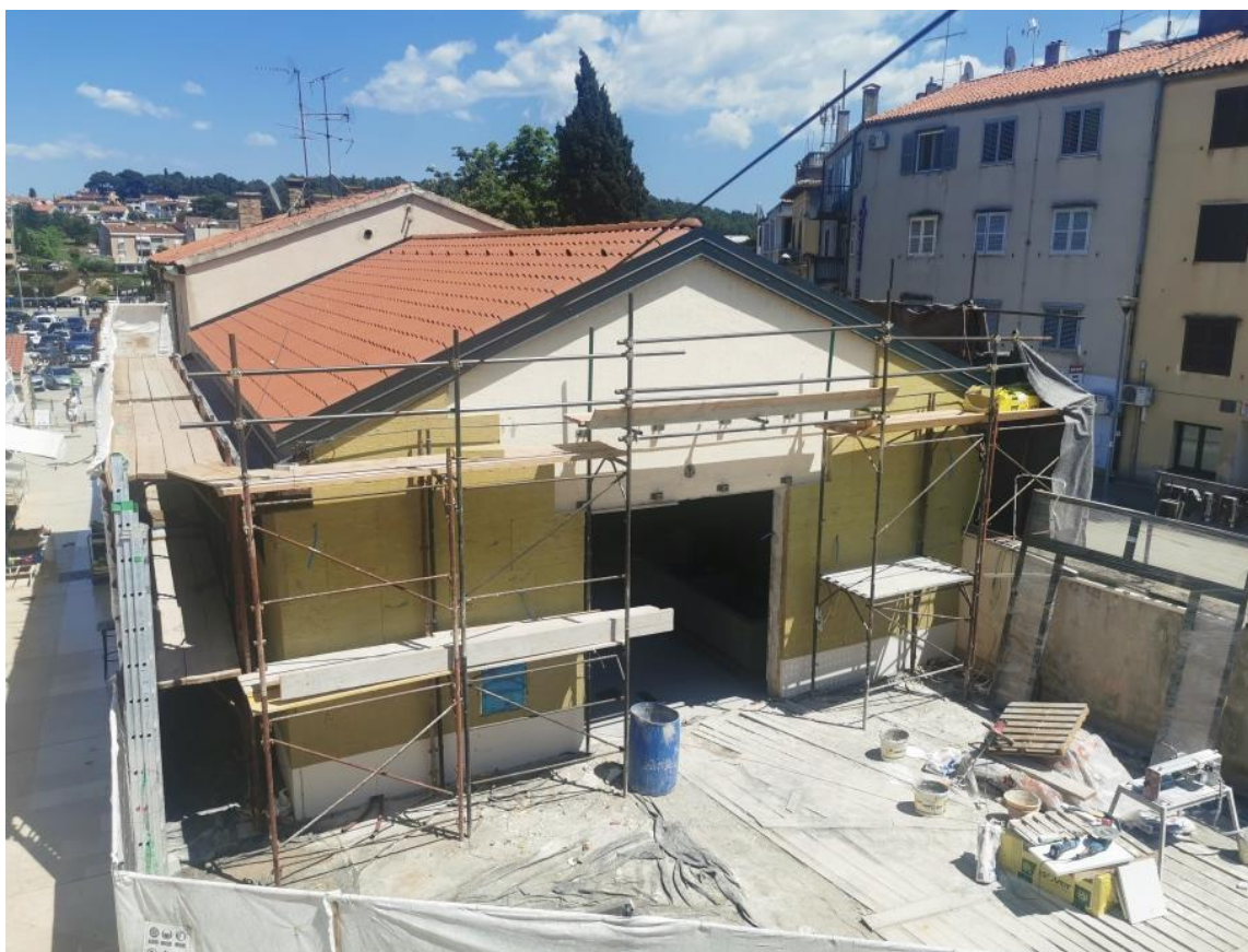
Slika 4. Preuređenje ribarnice Poreč
