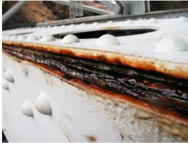
Slika 5: Procijepna korozija konstrukcije mosta [11]
