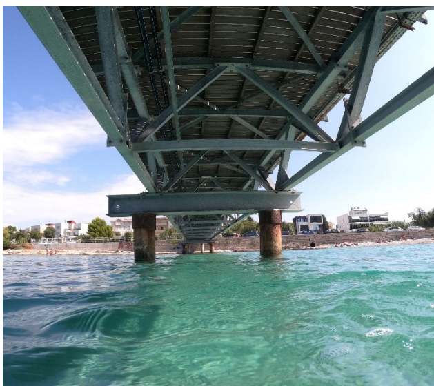
Slika 16. Most i metalni stupovi u sklopu ski-lifta izvan vode (izvor: osobna arhiva).
