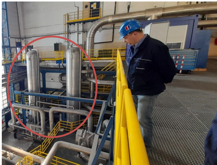
Slika 25. Visokotlačni regenerativni zagrijači napojne vode [autor]
