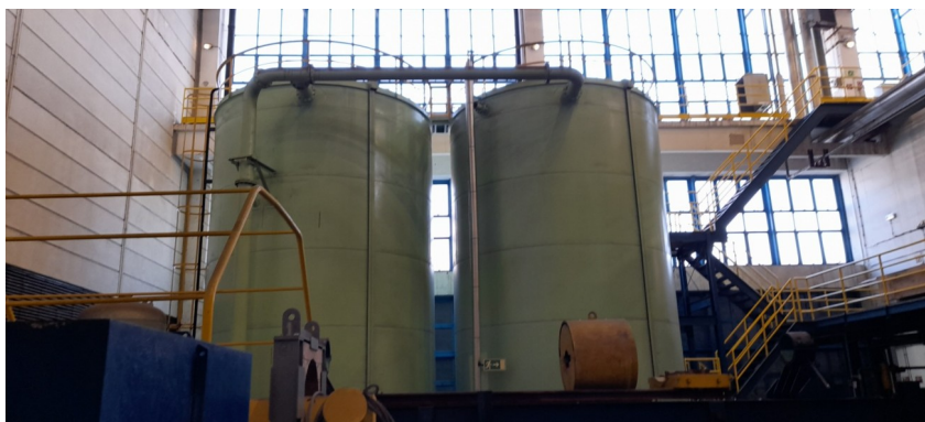
Slika 33. Spremnici demineralizirane vode unutar elektrane [autor]
