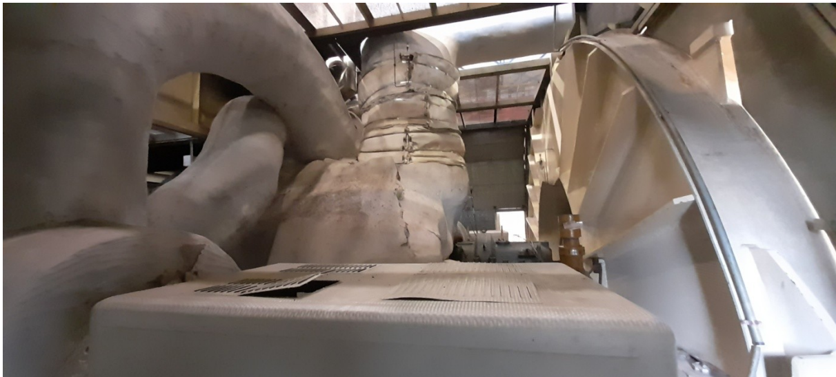
Slika 39. Srednjetlačni dio turbine [autor]
