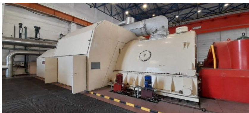
Slika 37. Turbinsko postrojenje izvana [autor]
