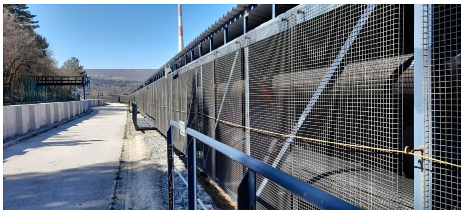
Slika 30. Transportni sustav ugljena prema elektrani [autor]
