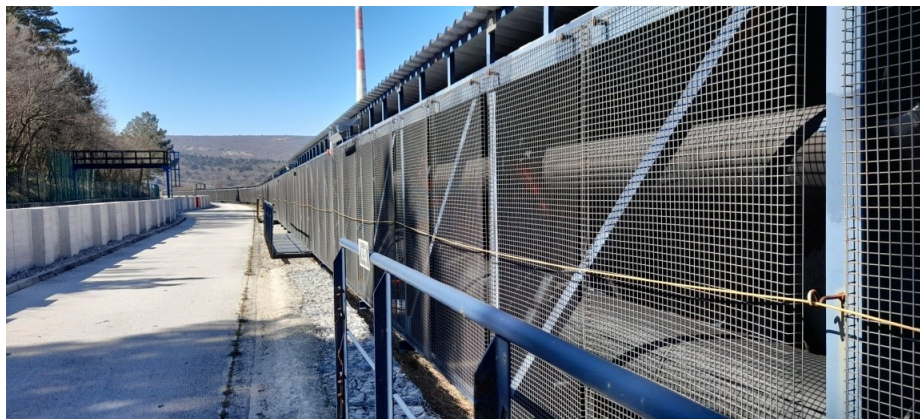
Slika 30. Transportni sustav ugljena prema elektrani [autor]
