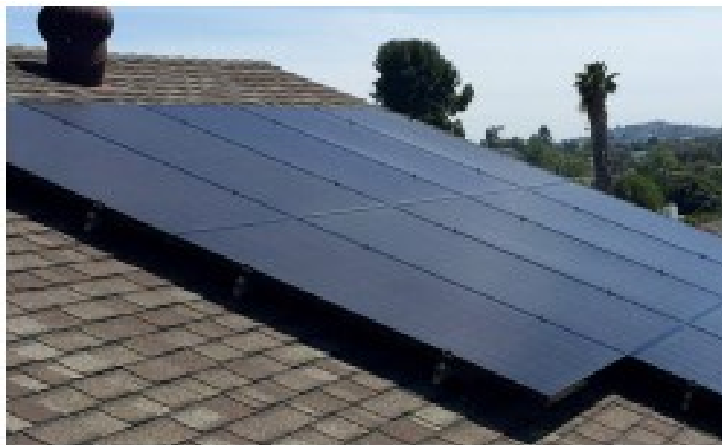
Slika 19. Fotonaponski sustav na tračnicama za kosi krov
