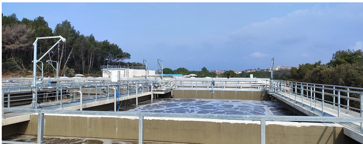
Slika 3. Postrojenje za pročišćavanje otpadnih voda – UPOV Cuvi
