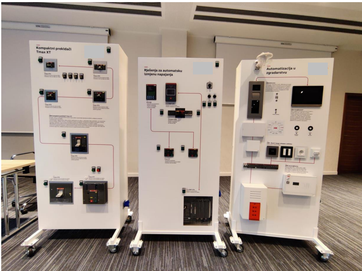
Slika 65. 3 ormara koje je Škamp d.o.o. izradio – s lijeve strane ormar opisan u radu
