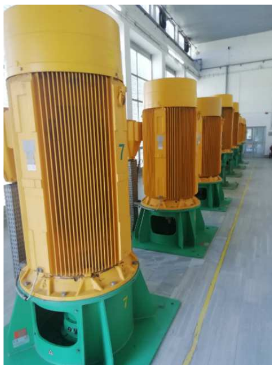
Slika 5.2 Crpna stanica Gradole
