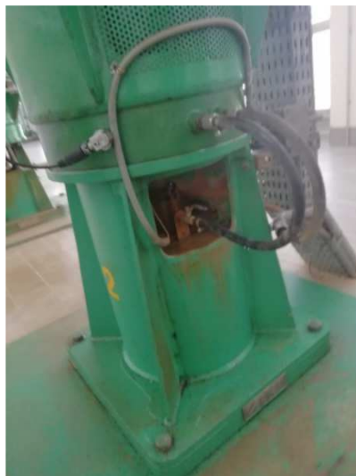
Slika 5.15 Mjerenje vibracija u smjeru V na položaju A CA 2 crpne stanice Gradole
