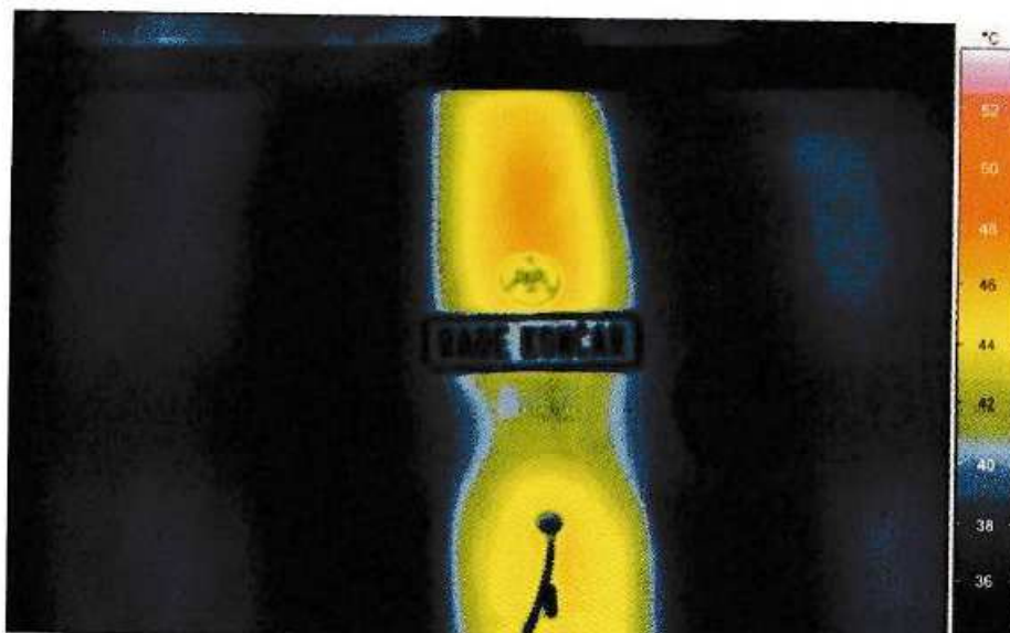
Slika 4.18 Izlazni rezultat periodičkog nadzora turbogeneratorskog kućišta termografijom
