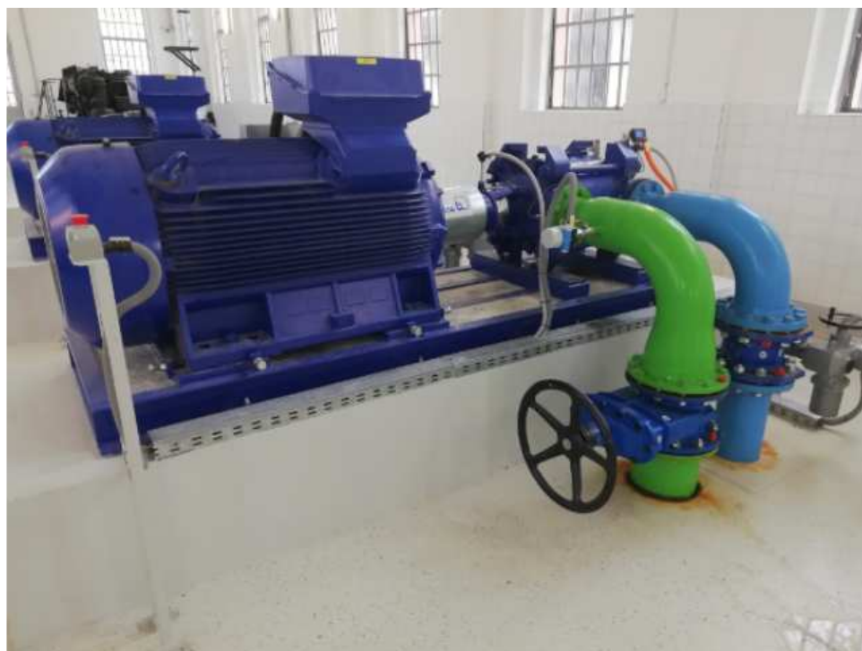
Slika 5.1 Crpni agregat 3 i 4 crpne stanice Sv. Stjepan
