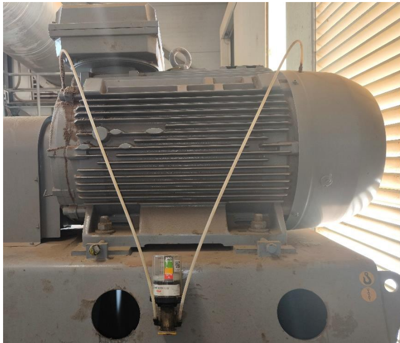
Slika 6.19. Elektromotor 315 kW i automatska mazalica
