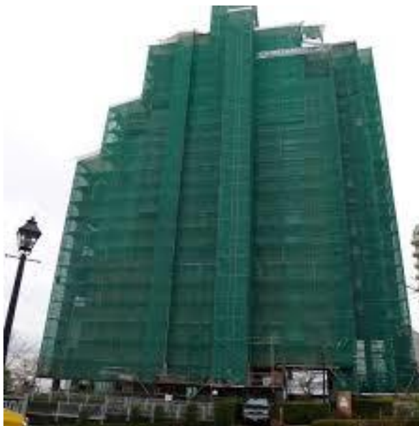
Slika 20. Zaštitna mreža na zgradi
