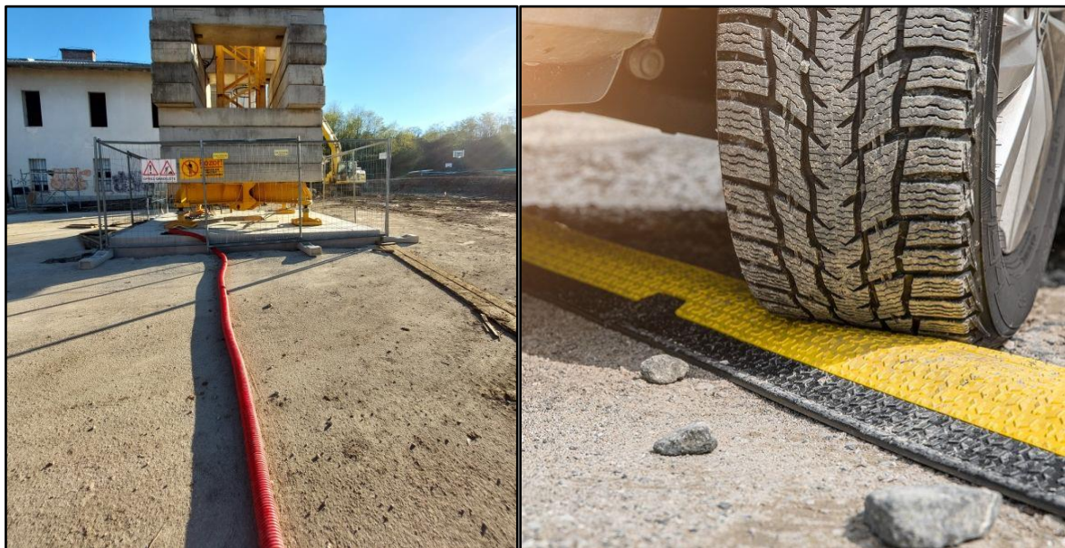
Slika 6: Zaštita električnih vodova od mehaničkih oštećenja
