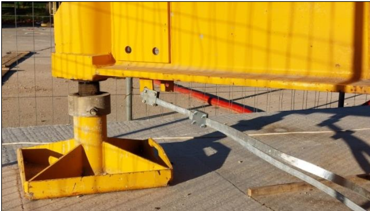
Slika 7: Spoj uzemljivača na metalnu konstrukciju dizalice
