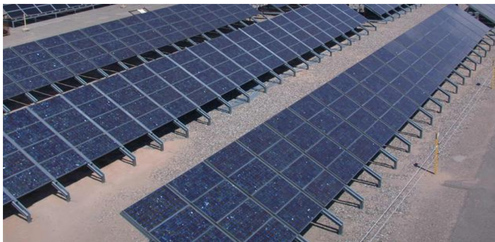
Slika 2. Fotonaponski solarni sustav (Izvor: http://www.zelenaenergija.org/clanak/solarne-fotonaponske-celije-fotocelije/429 , 2016.)
