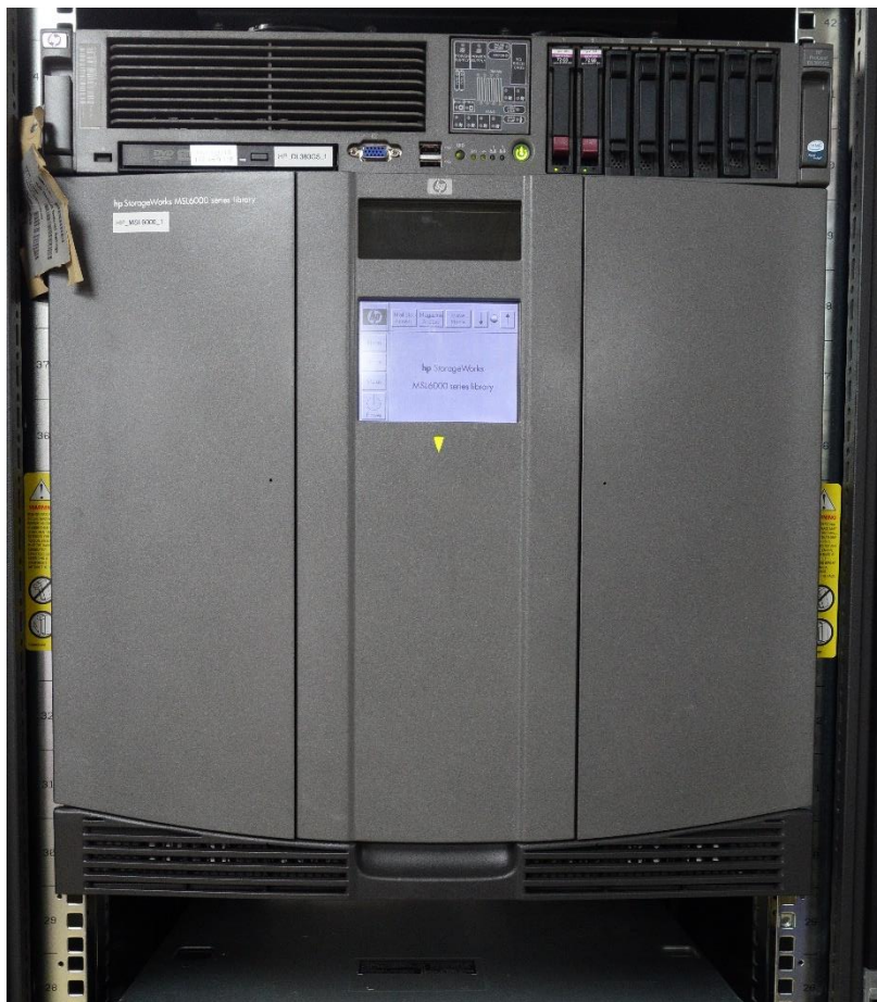
Slika 21. Sustav za backup podataka u podatkovnom centru
