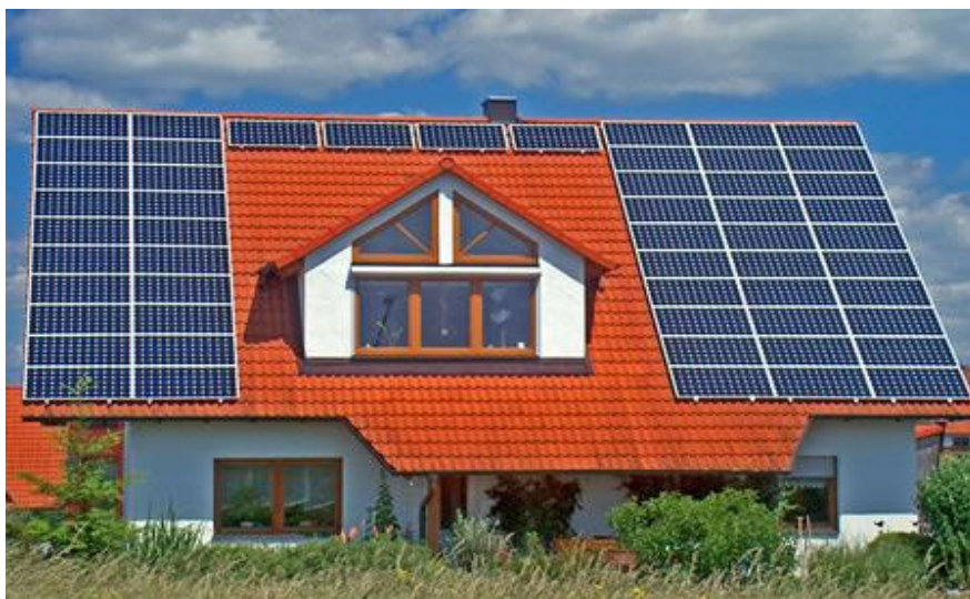
Slika 1. Obiteljska kuća sa solarnim kolektorima montiranih na krovu
