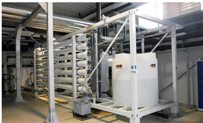
Slika 17. Sustav za obradu vode
