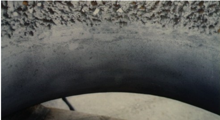
Slika 2.9. Usisno zvono oštećeno kavitacijskom erozijom
