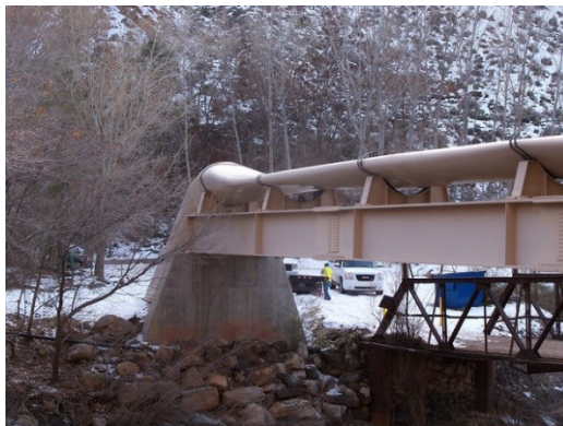
Slika 2.10. Kolaps cijevi u SAD, 1820 mm čelična cijev
