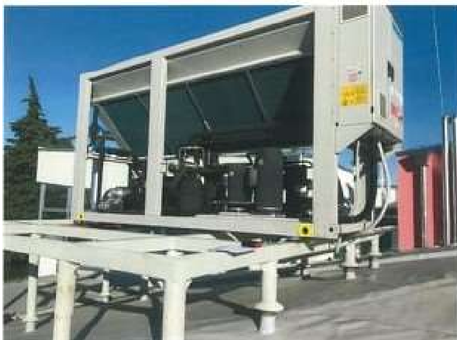
Slika 14 Dizalica topline – iznad strojnice vrtića
