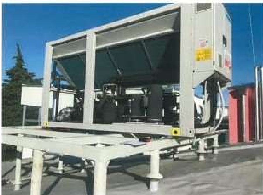
Slika 14 Dizalica topline – iznad strojnice vrtića
