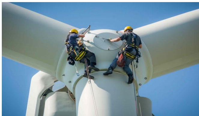
Slika 6. Prikaz održavanja vjetroelektrane
