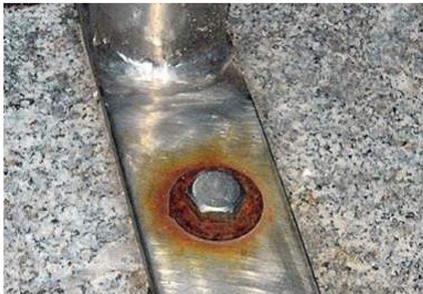
Slika 3 Česti primjer galvanske korozije koji se susreće u svakodnevnom životu. Izvor: https://qph.fs.quoracdn.net/main-qimg-dd1c9e2f7bbaf14ab142360f5cb6b03
