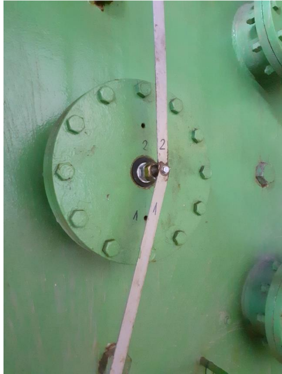
Slika 27 Prikaz prirubnice na kojoj se nalazi katodna zaštita. Moguće je vidjeti električni spoj prema ostatku sustava. Izvor: Autorska slika
