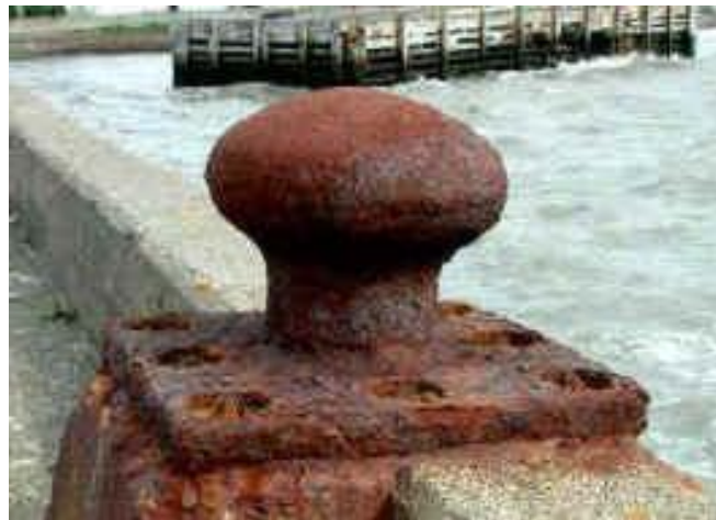
Slika 6 Primjer opće, jednolike korozije po cjelokupnoj površini. Izvor: https://higherlogicdownload.s3.amazonaws.com/NACE/cedda8a4-c3c0-4583-b1b6-3b248e6eb1f2/UploadedImages/Resources/uniform2.jpg
