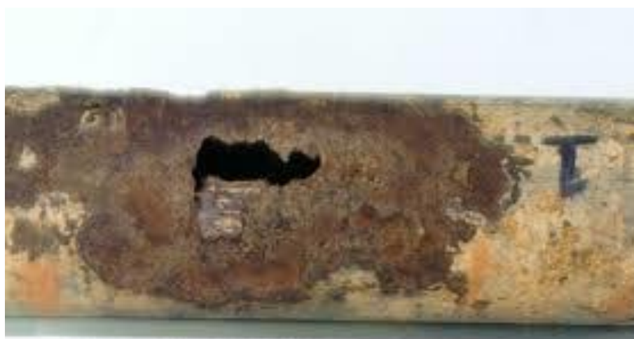
Slika 9 Primjer štete uzrokovan lutajućim strujama na cijevi. Izvor: https://www.canadianconsultingengineer.com/wp-content/uploads/2017/05/corrosion.jpg
