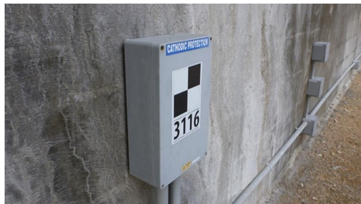
Slika 25 Primjer ormarića katodne zaštite na rashladnom tornju. Unutar njega se nalazi žrtvena anoda. Izvor: https://www.structural.net/wp-content/uploads/2018/10/iccp-system-2.png
