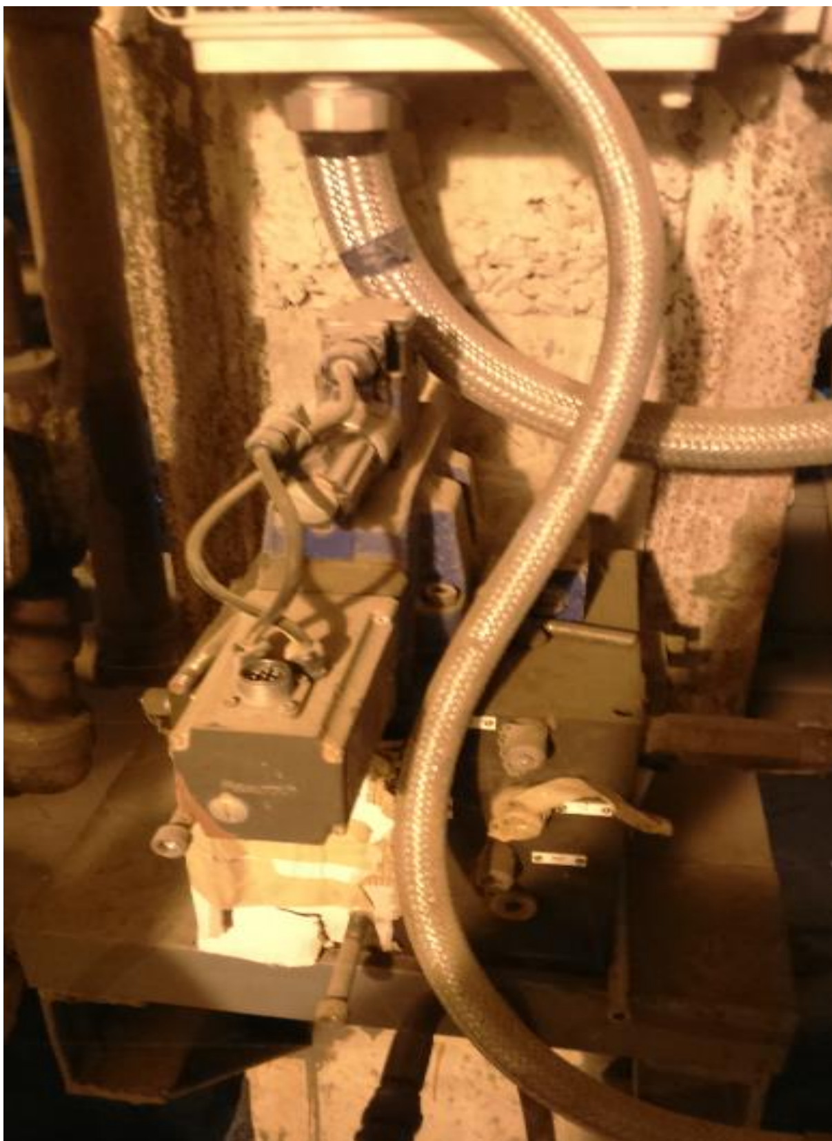
Slika 10 Izgled bloka ventila sa proporcionalnim ventilom
