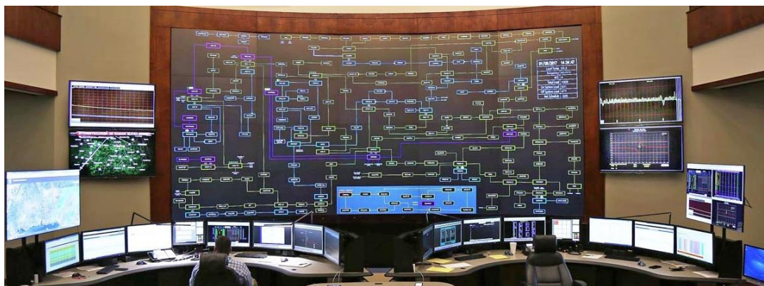
Slika 3: Kontrolna soba za nadzor elektro-energetskog sustava (LAMB, 2021)
