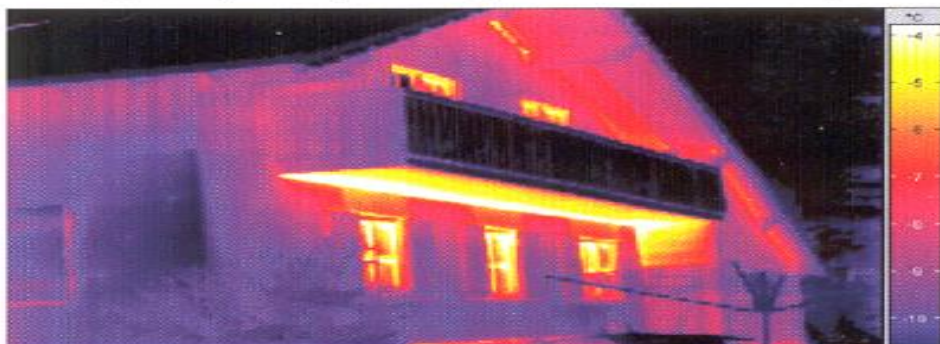
Slika 8. Termografski snimak kuće
