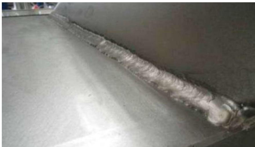
Slika 14. Primjer ugorina po cijeloj dužini zavara
