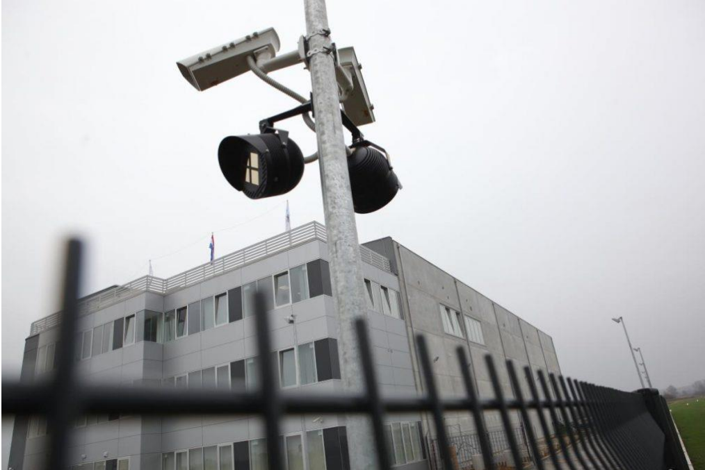
Slika 3. Protuprovala (izvor https://mydataknox.hr/o-nama/nasi-data-centri#! )
